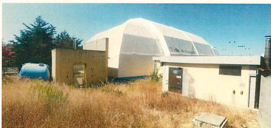
Foto 14 - centrali termiche e serbatoi
